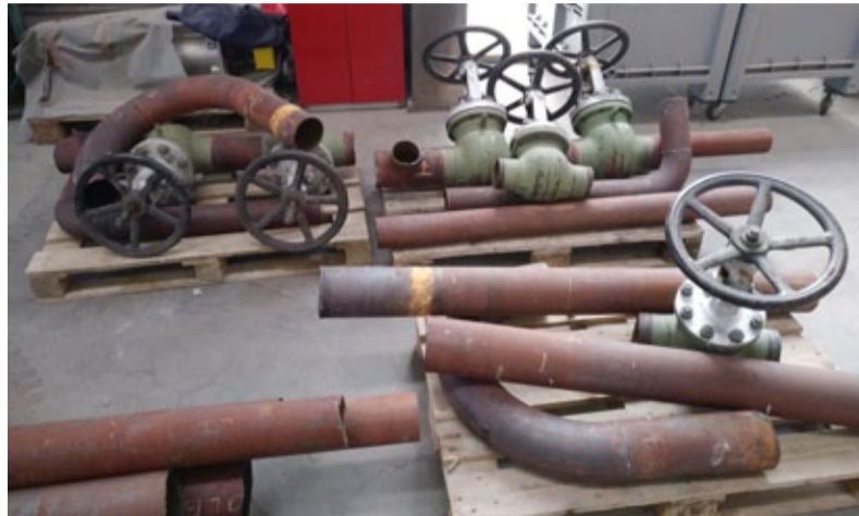
Einige der Hochdruck-Dampfleitungen und Armaturen, die nach 30jährigem Einsatz ausgewechselt werden mussten.
