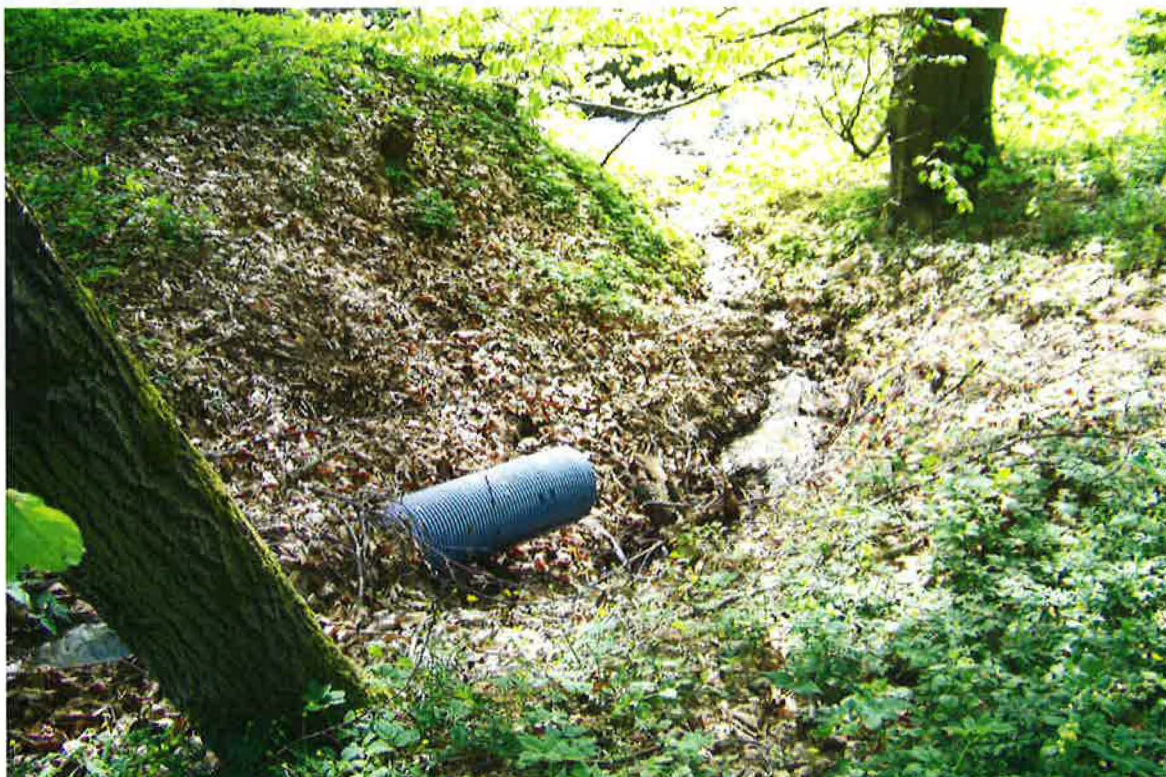
Abbildung 2: Absturz am Ende einer Verrohrung am Graben zum Tiefen Graben
