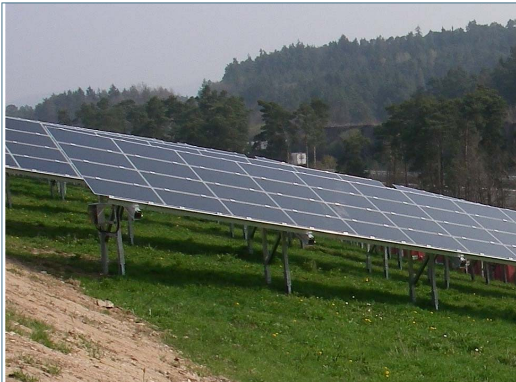
Abb. 1: PV-Module auf einer Deponie
